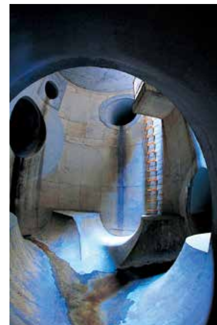
下水合流マンホール
