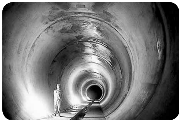
雨水幹線例：広瀬川第二雨水幹線 （写真提供：仙台市）
