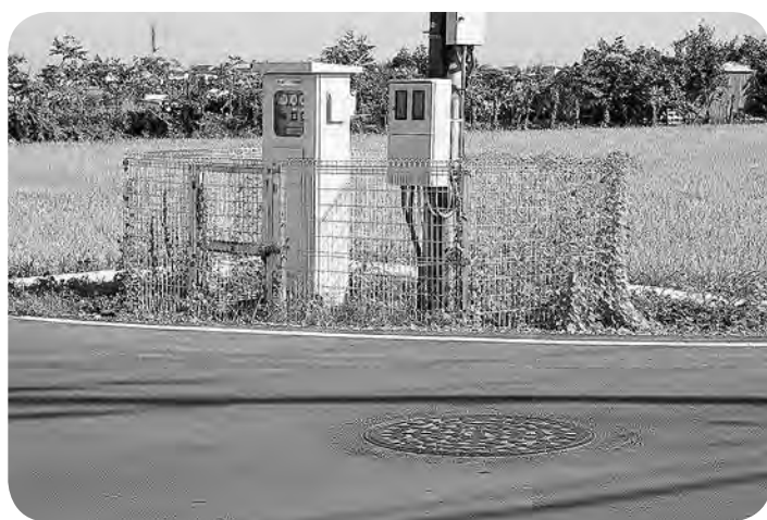
四ツ谷マンホールポンプ場（手前のマンホールの下）、ポンプ制御盤（奥のフェンスの中）
